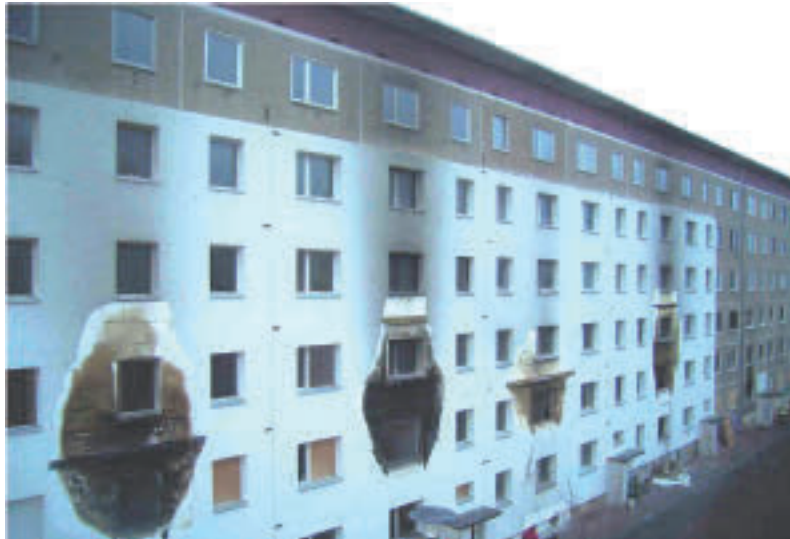
Abb. B10 Fassade des Versuchsgebäudes nach dem Brandversuch: Die eingebauten Brandriegel haben in unterschiedlichen Einbaupositionen und mit unterschiedlichen Materialien die Brandweiterleitung wirksam gestoppt.
